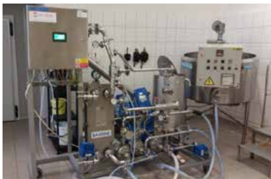
Poloprovozní pilotní ultrafiltrační stanice
